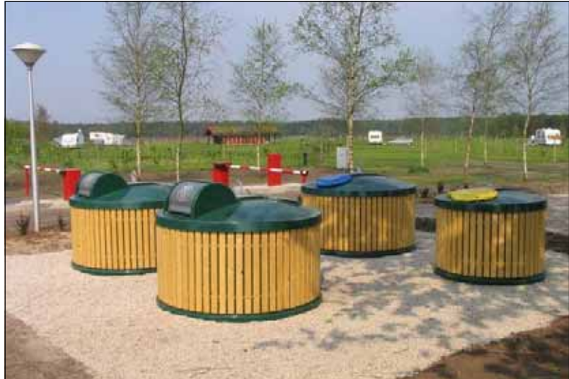
Halbunterflurbehälter "Tiërso" für die Abfalleinsammlung und Trennung (Camping Wolfheze, NL)
