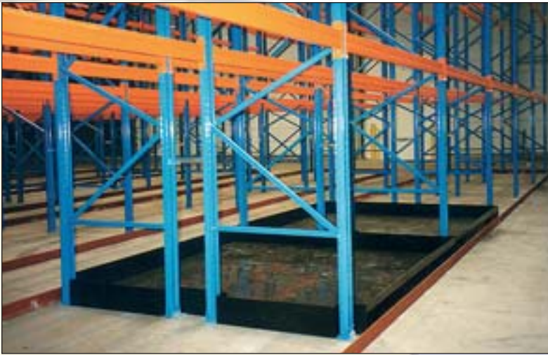
Auffangwannen, individuell genau passend für die abgebildeten Regalgerüste in diesem Palettenlager.
